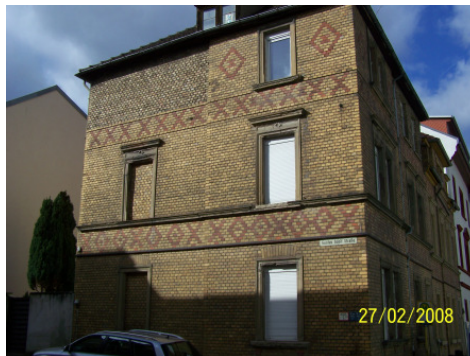
BU: Das über 100 Jahre alte Backsteinhaus in Bingen wurde von innen komplett gedämmt.
